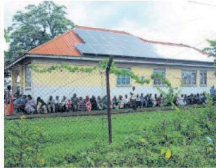
Die aus Spenden finanzierte Solaranlage sorgt für gesicherte Stromversorgung.
